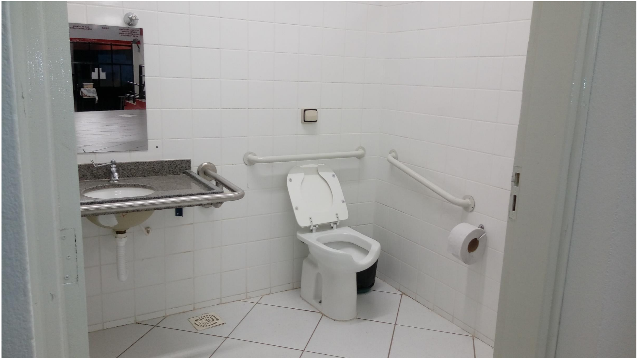
Banheiro adaptado para portadores de necessidades especiais
